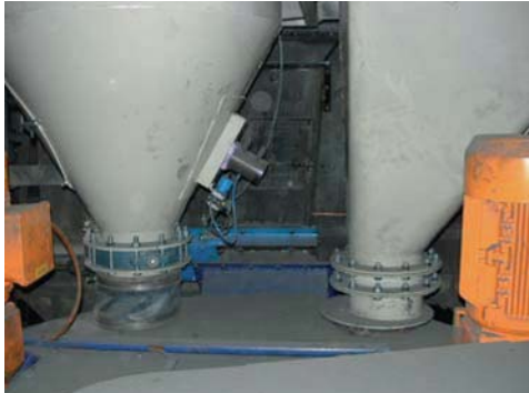
Abreinigen von festen Anbackungen mit Druckluft-Kolbenvibratoren
